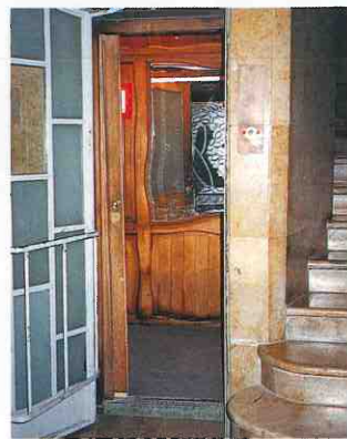
居住者用エレベーター、中は広いがドアの幅は車いす対応になっていない
