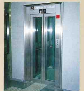
改札口フロア用エレベーター
